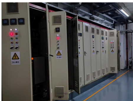
图 8 机房内 PLC 控制柜因温度过高开门散热
