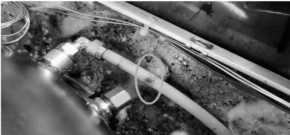
图 2 腔体安全阀漏气图
